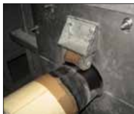
Fot. 15. Rolka oporowa zabezpieczająca przed unoszeniem oparta o rurę płaszcz osłonowy. (patrz fot. 14)
